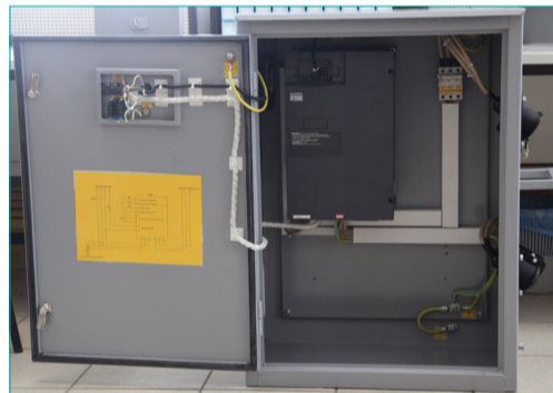
Станция управления с частотным преобразователем
